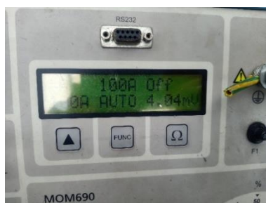
Gambar 9. Hasil pengukuran tegangan pada PMT fasa T
