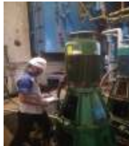
Gambar 3.3 Pompa CEP PLTU Air anyir
